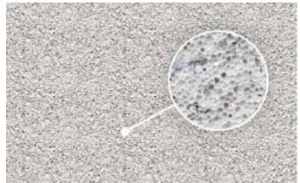
2-rasm. Gazobetonlardagi g'ovaklarning ko'rinishi
